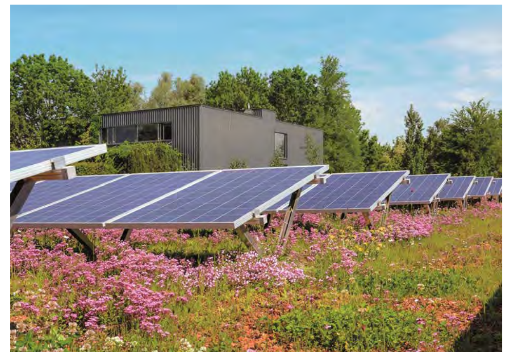
zonnepanelen op daken: regelmatig gerangschikt en dicht tegen het dakvlak
